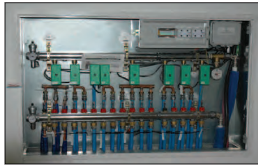
Fig. n. 3: Valvole motorizzate modulanti
