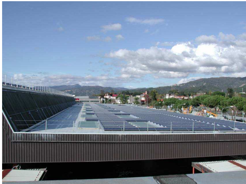
Figura 2 – Esempio di installazione idonea alla classificazione dell'impianto fotovoltaico nella categoria "su edifici" in caso assenza di una balaustra perimetrale
