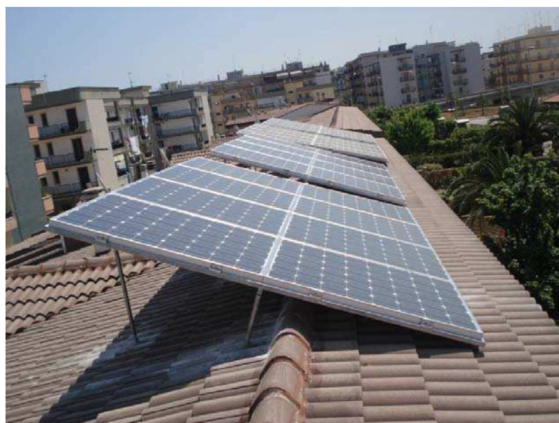
Figura 10 - Esempio di installazione non idonea alla classificazione dell'impianto fotovoltaico nella categoria "su edifici" – Motivazione: i moduli non rispettano la geometria della falda di copertura
