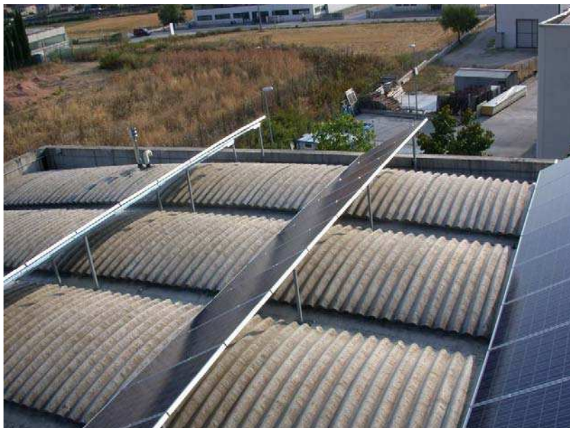
Figura 15 - Esempio di installazione non idonea alla classificazione dell'impianto fotovoltaico nella categoria "su edifici" – Motivazione: l'inclinazione dei moduli fotovoltaici rispetto al piano tangente supera i 10°.
