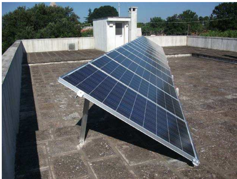
Figura 4 – Esempio di installazione idonea alla classificazione dell'impianto fotovoltaico nella categoria "su edifici" in caso di presenza di una balastra perimetrale
