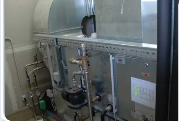
Unità di trattamento aria ventilazione meccanica
