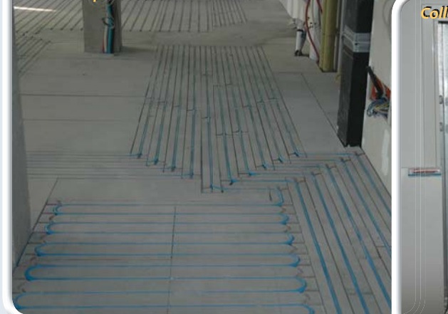
Pannelli a pavimento
