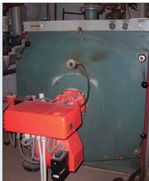
Fig. n. 6: Generatore di calore in funzione prima degli interventi.
